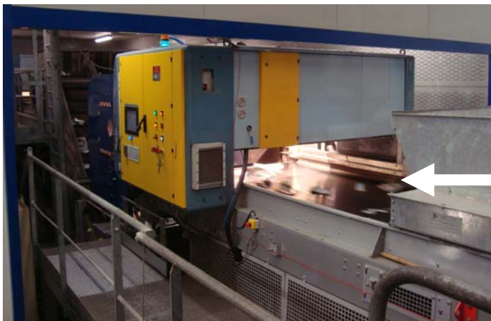
Passage sous tri optique
