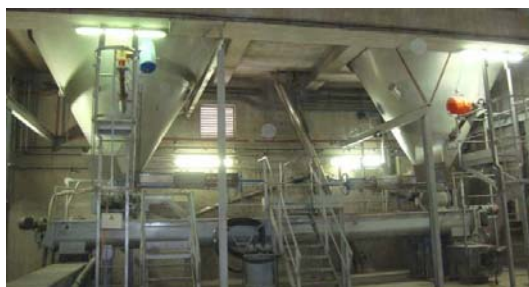
Silos de stockage des cendres
